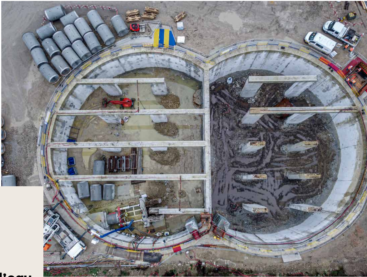
Station de dépollution des eaux pluviales à Champigny sur Marne
